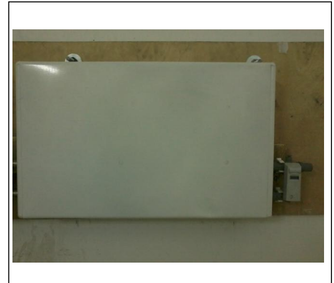
Фотография отопительного прибора
